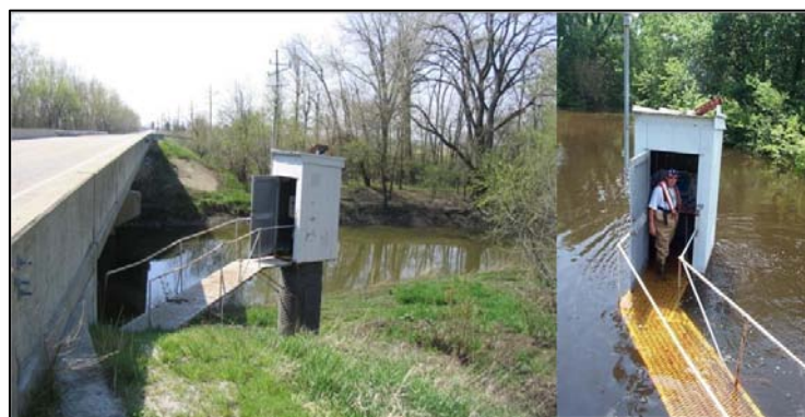
Figura 16. Foto do posto IN (esq.) mostrando alojamento do sistema de telemetria (dir.) durante uma enchente.
